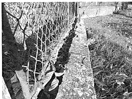
Poškodená podmurovka plotu od ulice
