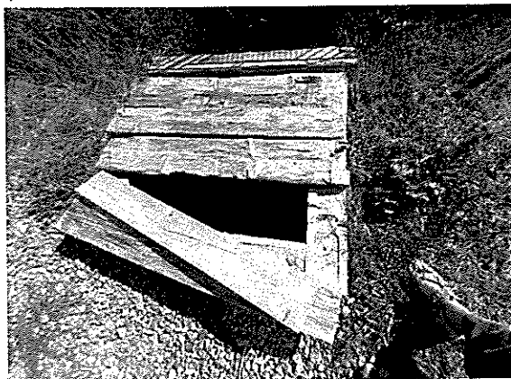
Vodomerná šachta v predzáhradke
