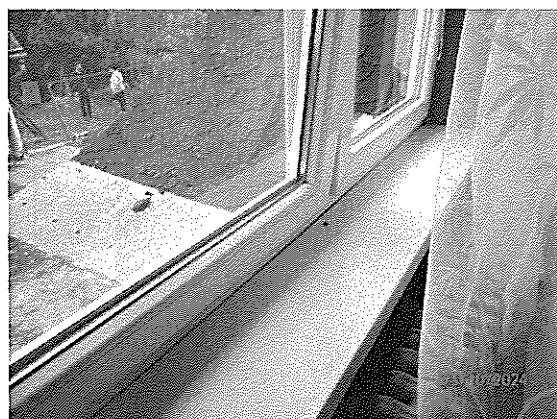
Detail okna zadnej izby
