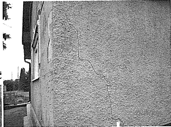
Prasklina muríva SZ rohu domu
