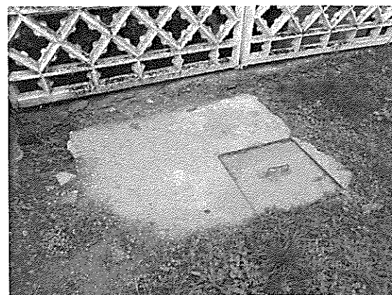
Vodomerná šachta na parc. 548
