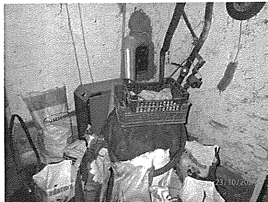
Dlhodobo nefunkčný kotol ÚK na zemný plyn
