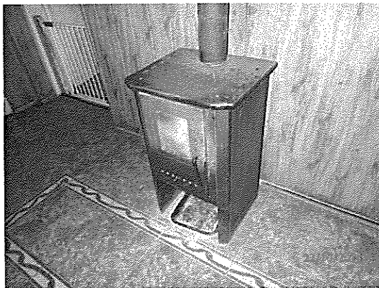
Piecka na tuhé palivá na chodbe
