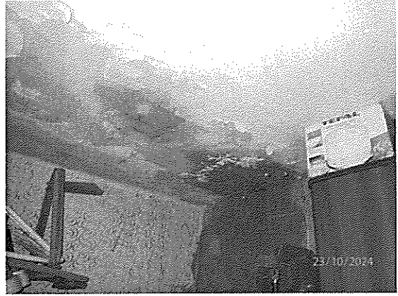
Strop garáže poškodený od zatekania strechy
