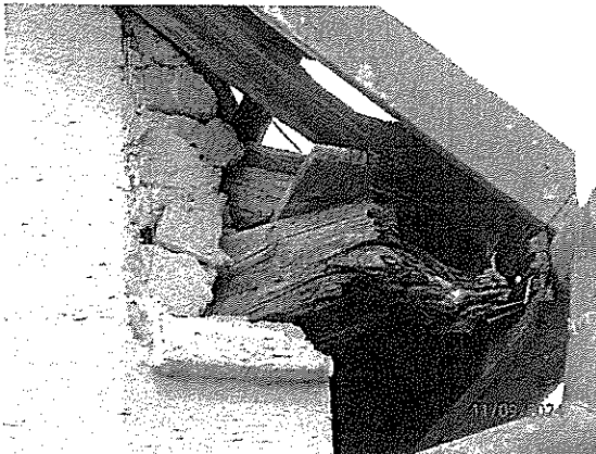
Detail poškodeného nárožia strecha domu od ulice
