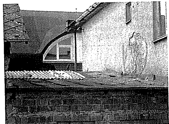
Poškodená strecha skladu za domom
