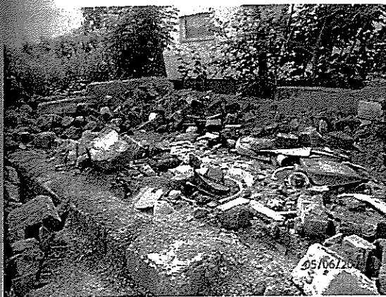
Zbúranisko po garáži na parc. 382/4
