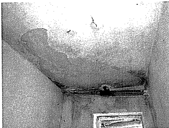
Poškodený strop práčovne na I.NP
