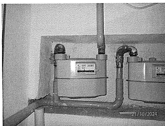
Plynomery na chodbe pre podkrovné byty
