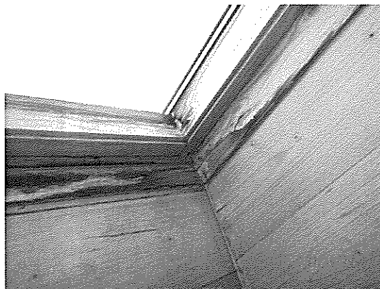
Sirešné okno Velux v byte
