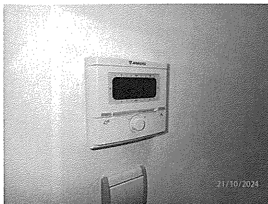
Izbový termostat pre byt na chodbe
