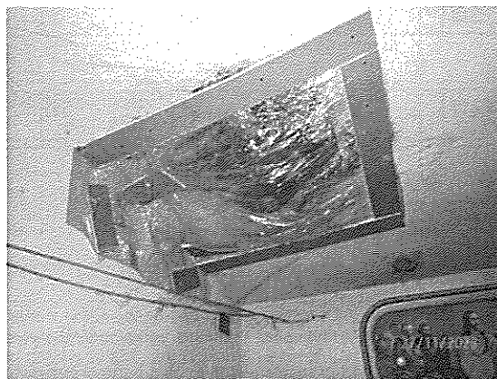
Poškodený strop zadnej izby od strechy
