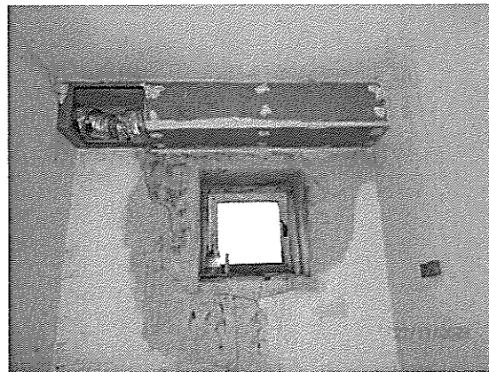
Poškodené murivo v komore od strechy
