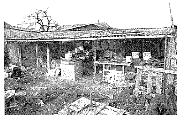
Schátraná nefunkčná hospod. stavba za domom
